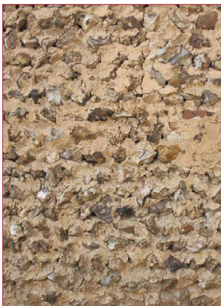
Maçonnerie en silex dégarnie.
