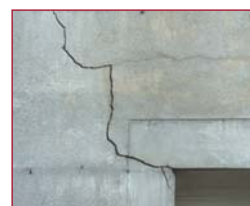
Enduit* ciment sur une maçonnerie ancienne : fissurations
